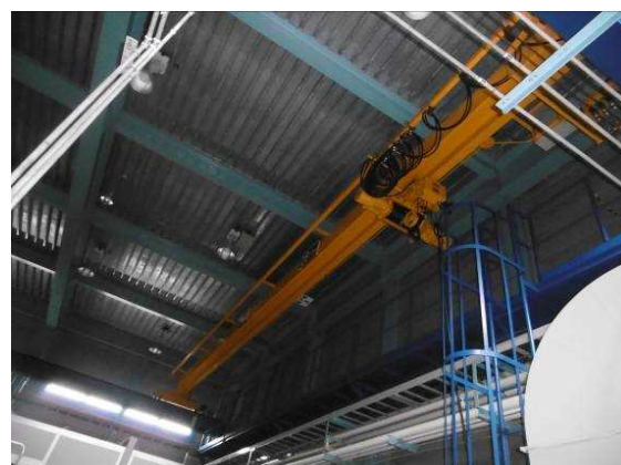
ホイスト式天井クレーン設備
