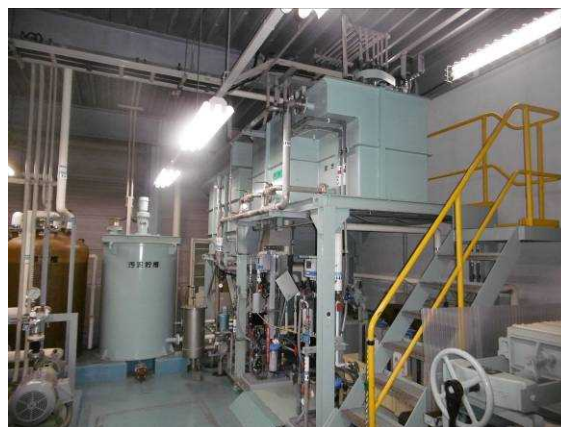
排水処理設備
