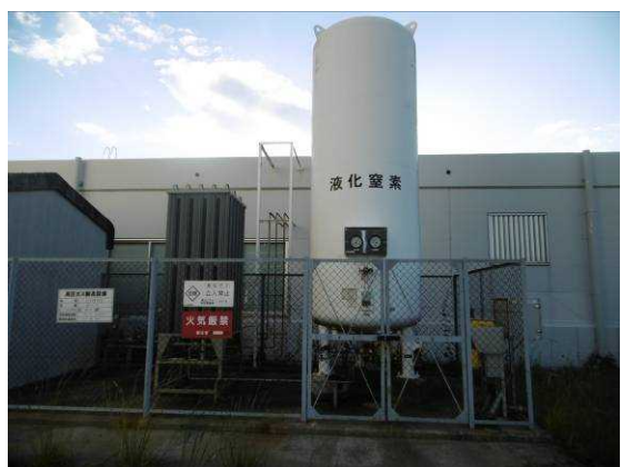
一般高圧ガス製造施設設備
