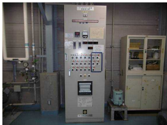
ユーティリティ排水設備
