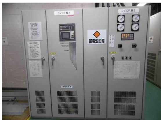
無停電電源装置設備
