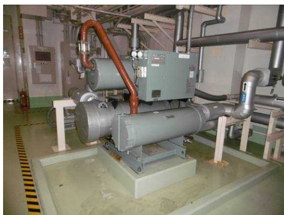
冷水・冷却水設備
