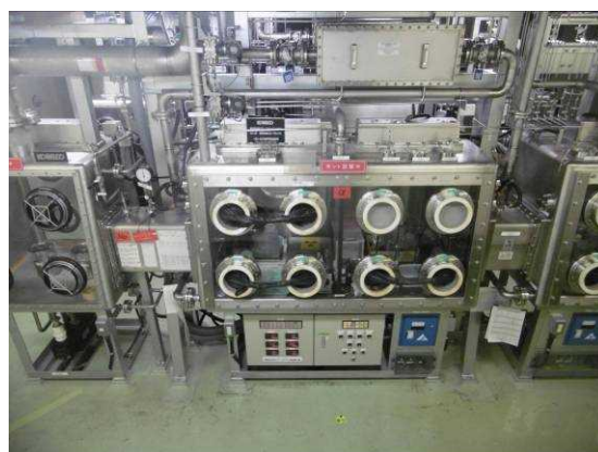
雰囲気制御装置グローブボックス設備
